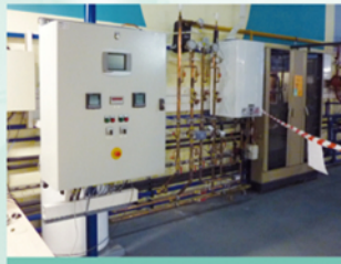
co-générateur gaz Stirling (génie climatique et énergétique)
