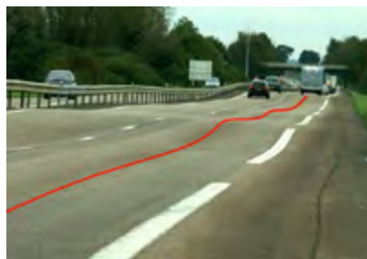
Figure 1 : Illustration de malformation de chaussée
