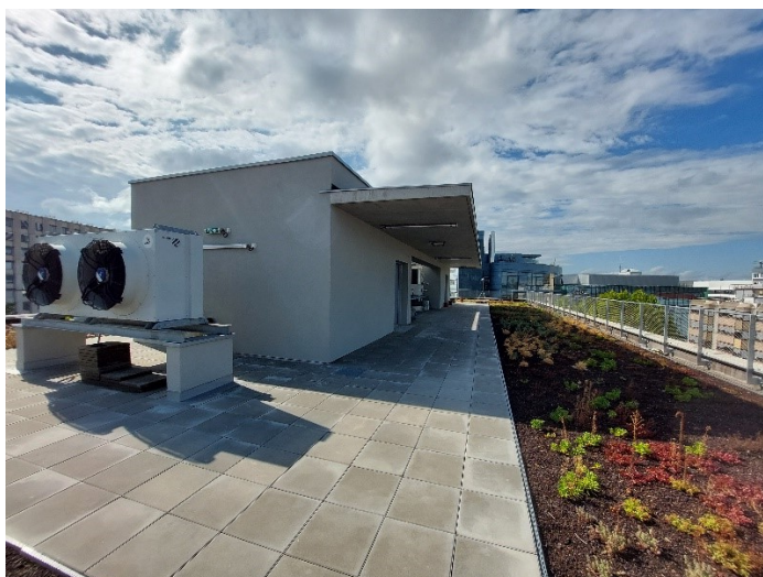
Aéroréfrigérant en toiture
